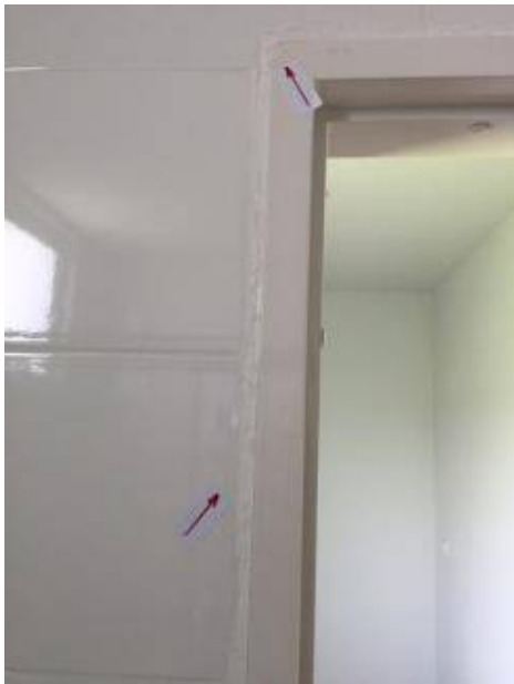
2.ทำความสะอาดบานประตู + เก็บงานวงกบโดยรอบทั้งหมด
