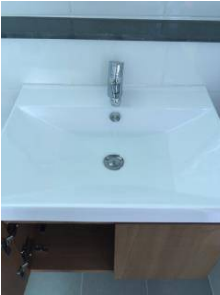
4. น้ำไหลไม่แรงเช็คระบบน้ำ
