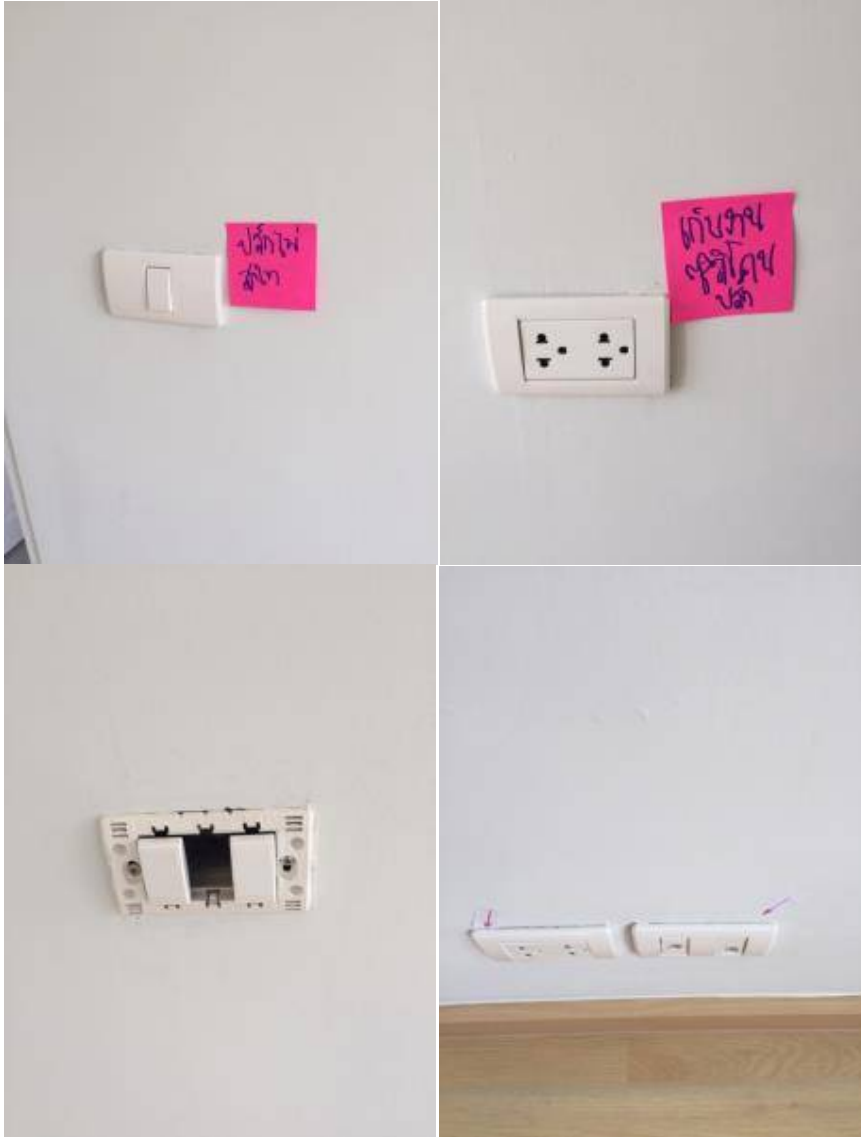
4. ปลั๊กติดไม่สนิท ซิลิโคนขอบปลั๊กใหม่ทุกอัน
