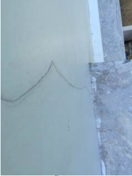
หมายเหตุ ผนังมีน้ำซึม นอกกระเบื้องตรงหน้าต่าง.
