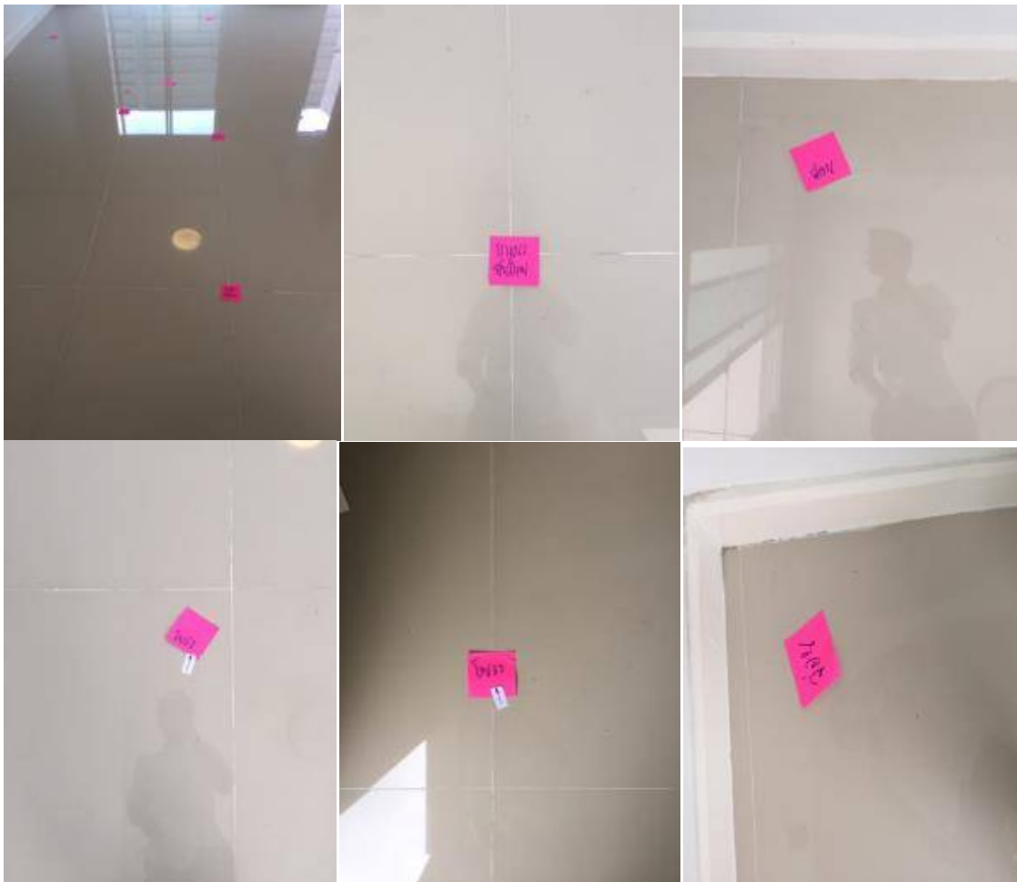
2. ยานแนวพื้นใหม่+พื้นล่อน+เป็นรอย+พื้นปูไม่เสมอกัน(เปลี่ยนใหม่)+กระเบื้องเป็นคราบ ทำความสะอาดทั้งหมด
