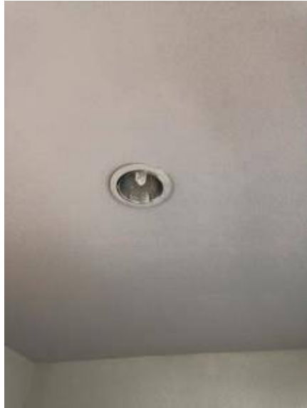
หมายเหตุ สีหลอดดาวไลท์ตรงชั้น3
