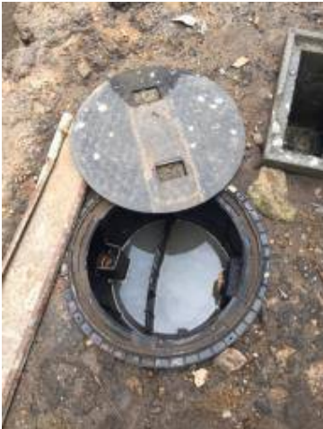
6. ตัดกัไขมันติดตั้งเบี้ยว+ไม่ได้ติดตะแกรง+ทำความสะอาด
