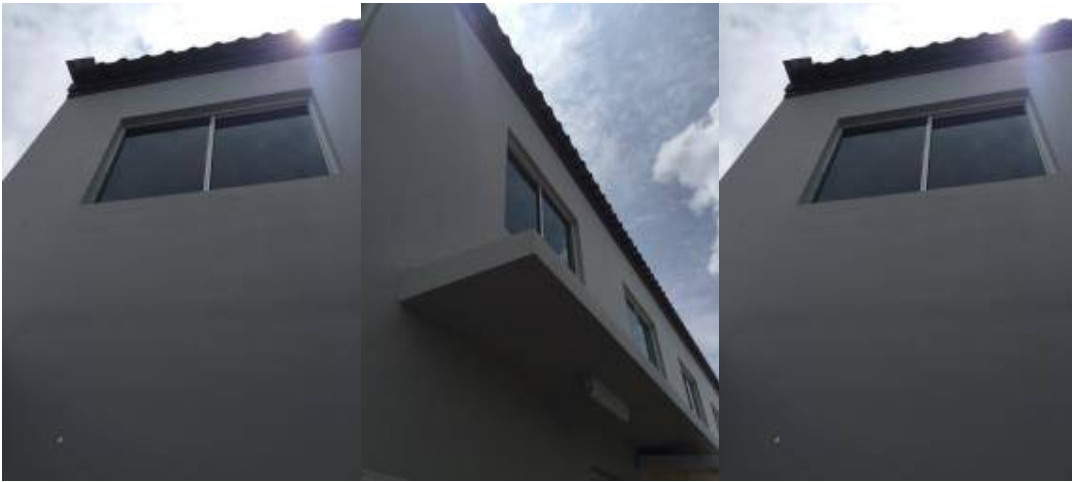
5. ผนังภายนอกทาสีใหม่ทั้งหมด+เช็ดน้ำรั่วซึมผนัง+ตามรอยร้าวทั้งหมด รวมถึงขอบหน้าต่าง
