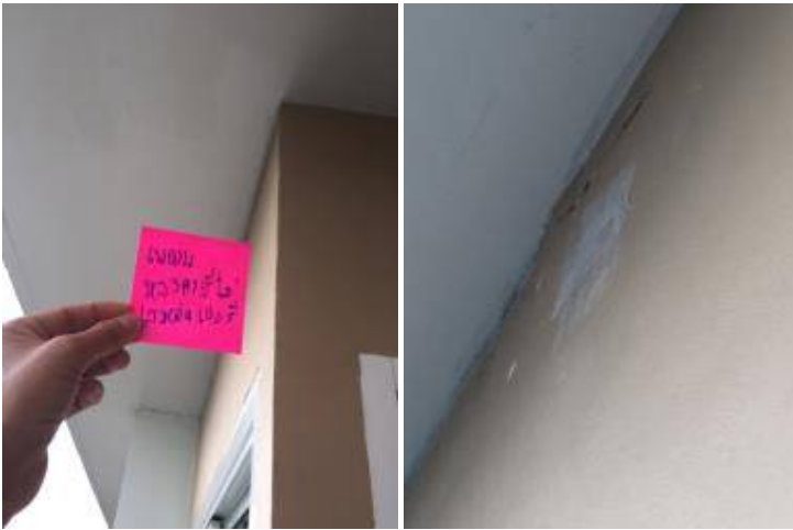
5. เก็บสีเพดานหลังคาสีไม่เหมือนกัน
